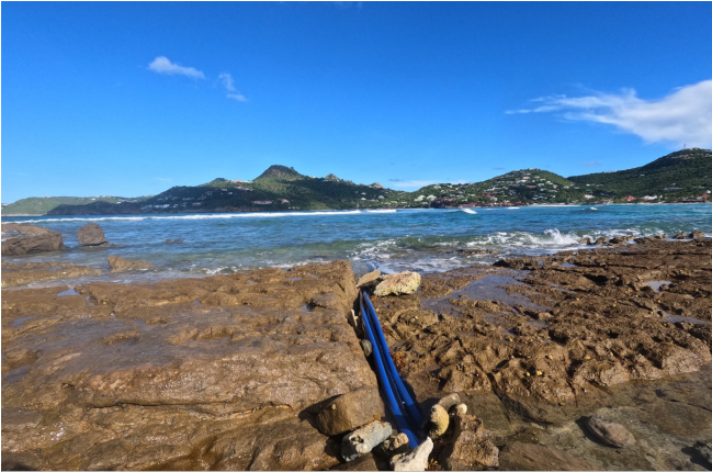
Cable vers l'eau
